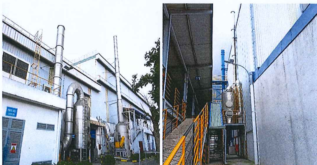
Hình 2.15: Một số hình ảnh hệ thống xử lý khí thải tại nhà máy
