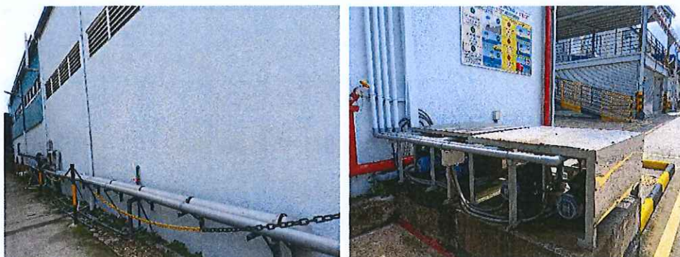
Hình 2.11: Một số hình ảnh hệ thống xử lý nước thải sản xuất
