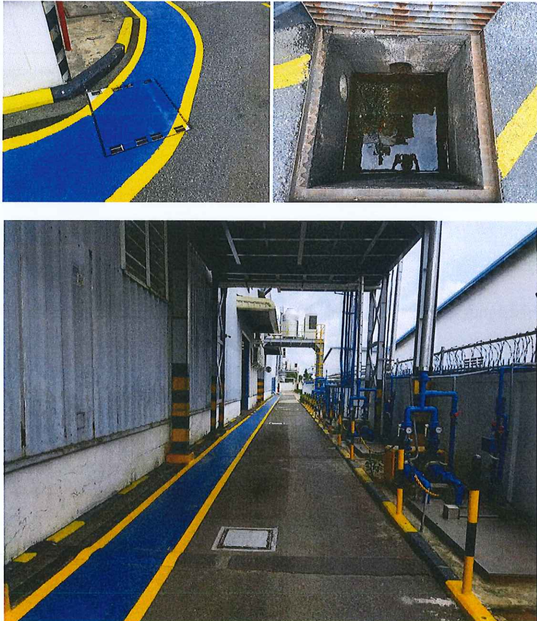
Hình 2.3: Một số hình ảnh vị trí thu gom, thoát nước mưa của nhà máy
