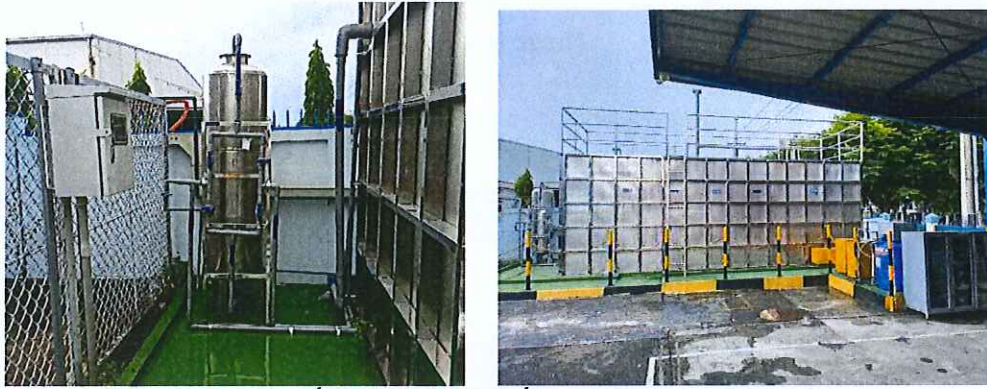
Hình 2.9: Một số hình ảnh hệ thống xử lý nước thải sinh hoạt
