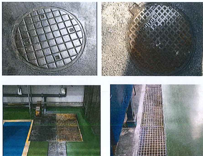
Hình 2.7: Một số hình ảnh vị trí thu gom, thoát nước thải của nhà máy
